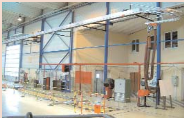
Banc de contrôle pour TRM 10 000 et Scania (confection locale)
